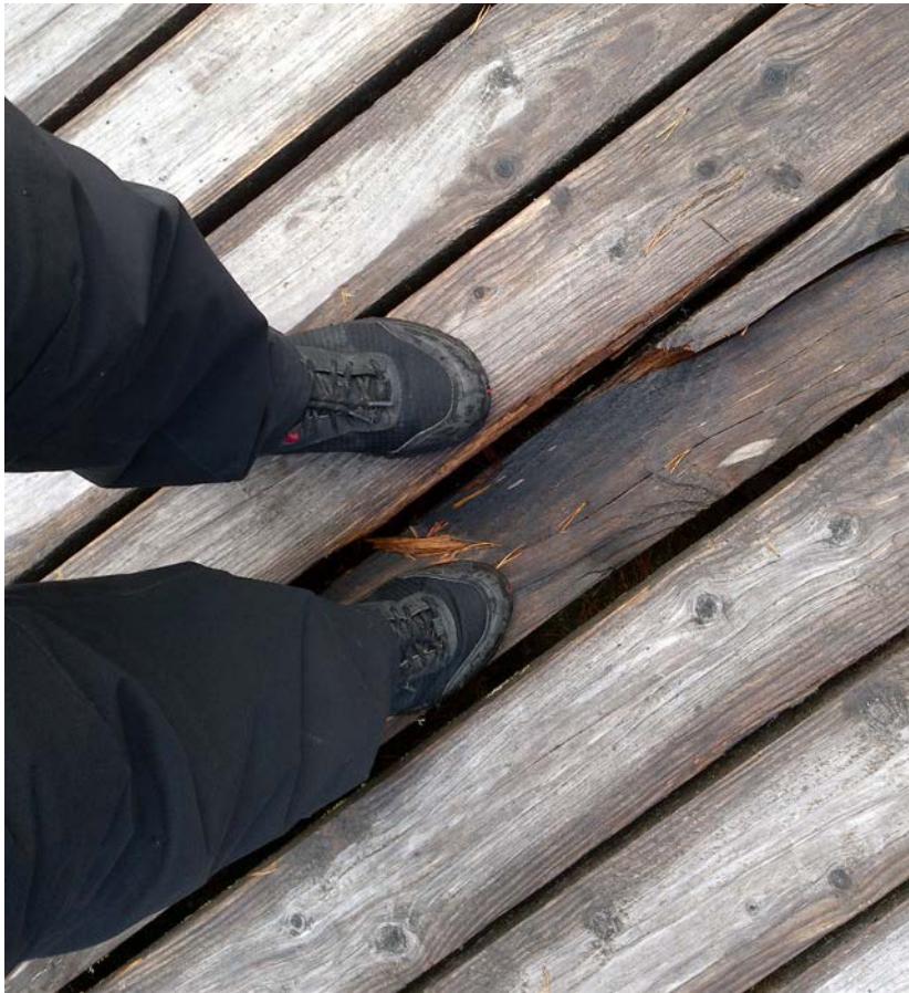
Kuva 14 Luupäänlenkin pyörätulisillalla lahoja lankkuja
